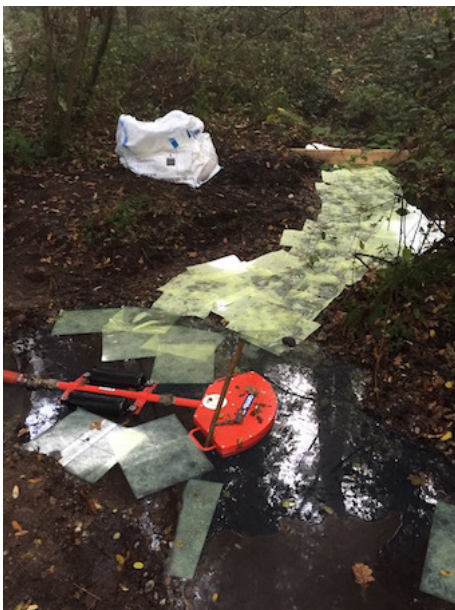
Foto 3. Attività diurna skimming e sostituzione fazzoletti al punto di risorgiva NORD (mappa 1 area 1)
