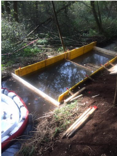
Foto 1. Barriera oleoassorbente a valle della vasca di filtrazione alla risorgiva SUD (mappa 1 area 2)
